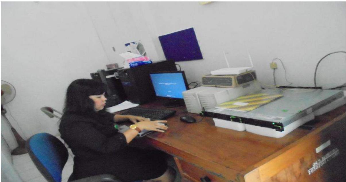
Gambar (3). Ruang IT (server) PTUN Palangka Raya
